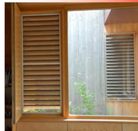
Nachtluftklappe im Passivhaus
