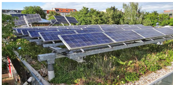
Photovoltaikanlage auf einem Gründach
