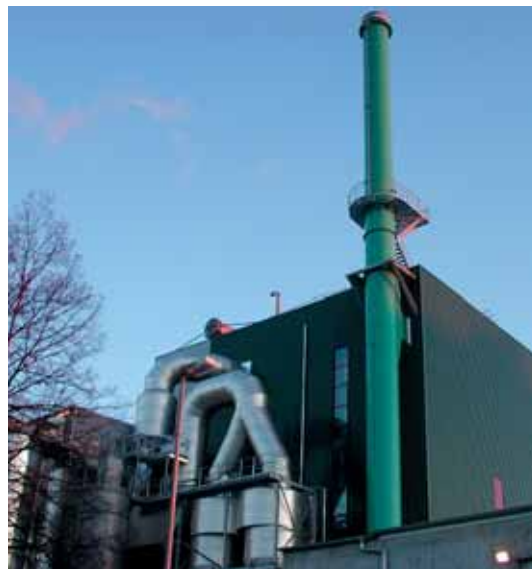
Biomasse Kraftwerk Fechenheim, Abgasreinigung
