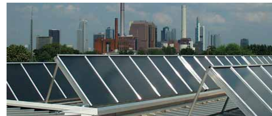
Solaranlage auf dem Friedrichsheim
