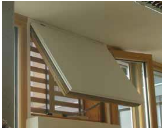
Bild 4: Nachtluftklappe (Quelle: Hochbauamt FFM)
