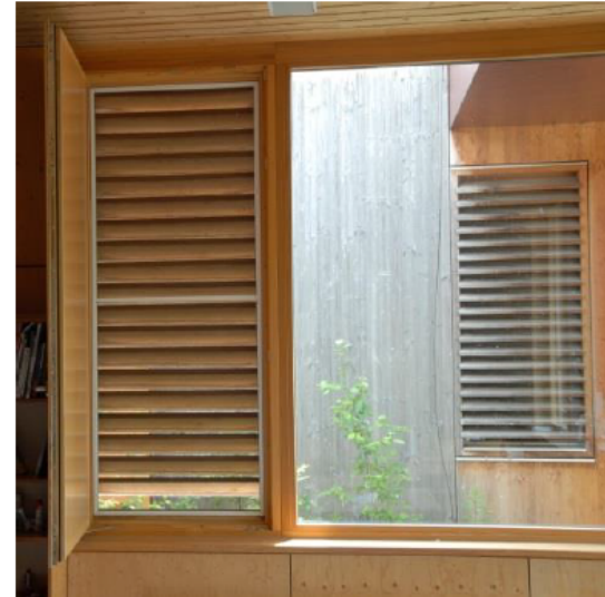
Abb.: Nachtlüftklappe Albert-Schweitzer-Schule (Quelle: Amt für Bau und Immobilien)
