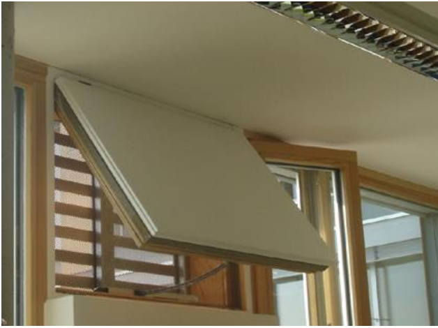
Abb.17 Nachtlüftungsklappen in der Grundschule Riedberg
