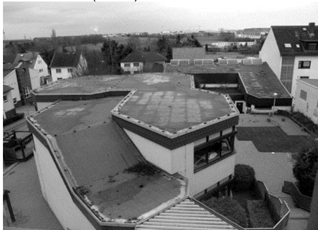
Abb.1 Ehemaliges Schulgebäude der Grundschule Frankfurt-Kalbach aus den 1970er Jahren mit Bauschäden
