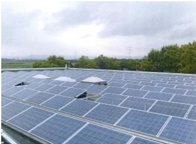
Abb.8 Solarkollektoren der Riedbergschule
