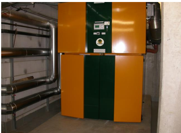
Abb.9 Pelletheizung der Liesel-Oestreicher-Schule
