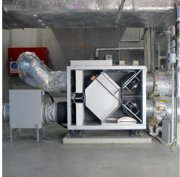
Lüftungsanlage Ludwig-Börne-Schule Foto: ABI, Abteilung Energiemanagement
