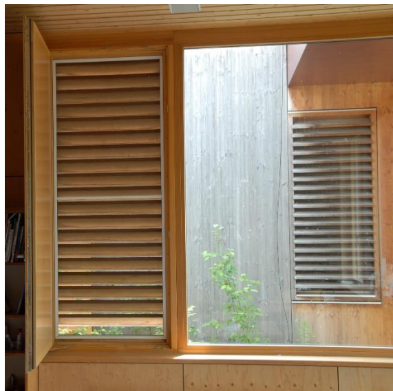
Nachtlüftungsöffnung Albert-Schweitzer-Schule, Foto: ABI, Abteilung Energiemanagement
