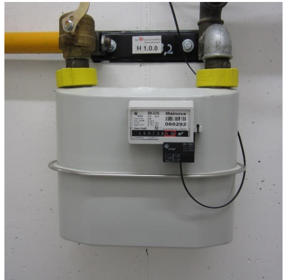
Gaszähler mit Impulsausgang
