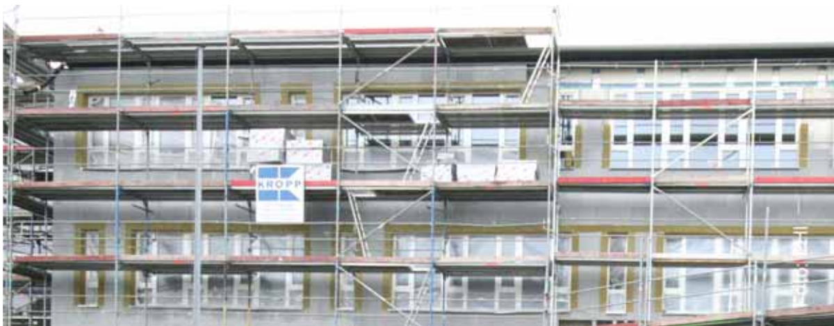
Abbildung 11: Albert-Schweizer-Gymnasium Alsfeld, Brandbarriere. Architektur: BLFP, Friedberg
