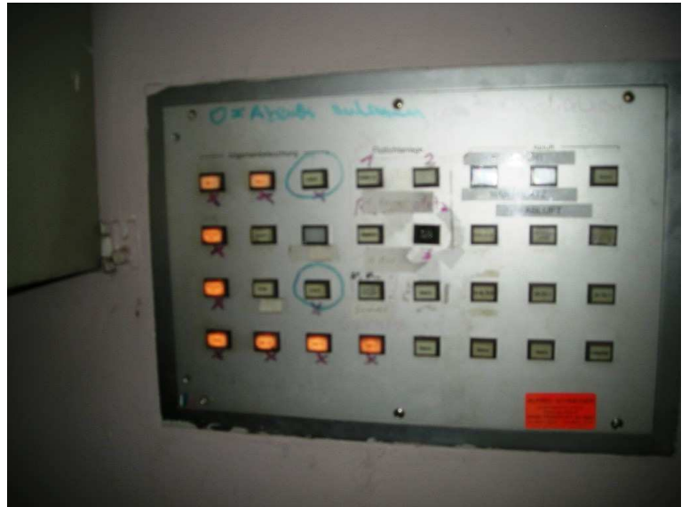
Schalttafel der Beleuchtung für den Umkleidebereich
