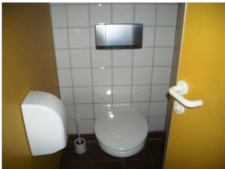
Toilette der Sportanlage
