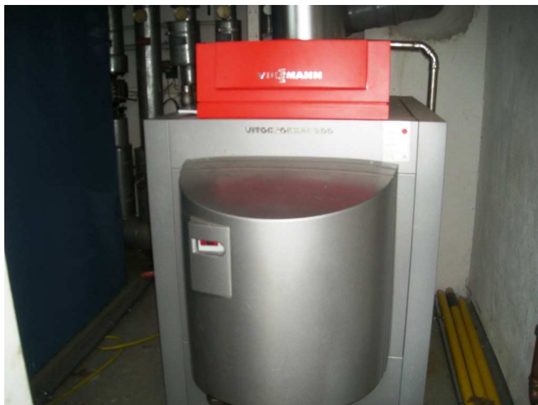
Heizungsanlage der Sportanlage
