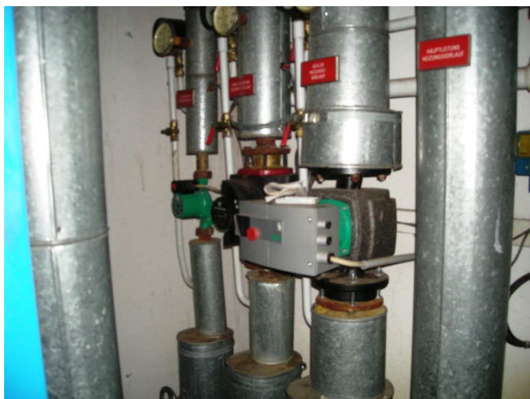
Heizkreisverteiler der Sportanlage
