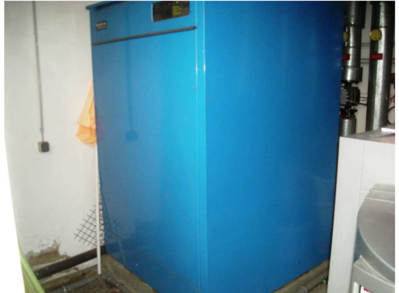
Warmwasserspeicher der Sportanlage
