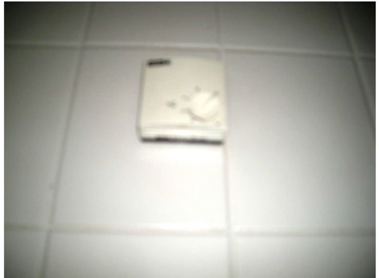
Hygrostat der Be- und Entlüftung der Duschräume
