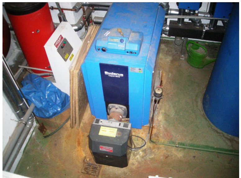
Heizungsanlage der Sportanlage
