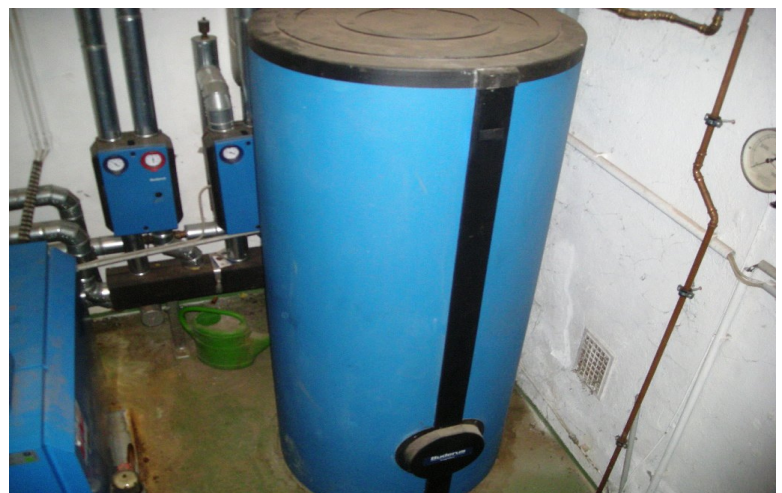
Warmwasserspeicher der Sportanlage
