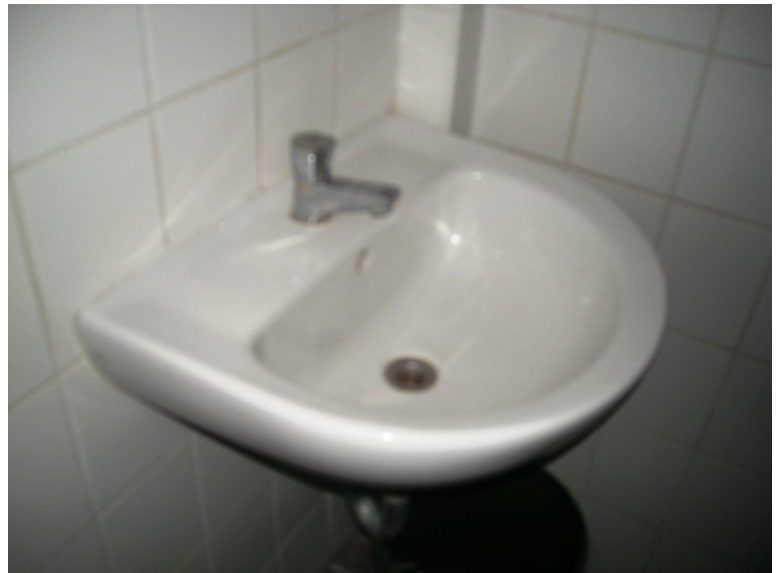
Waschtisch der Sportanlage
