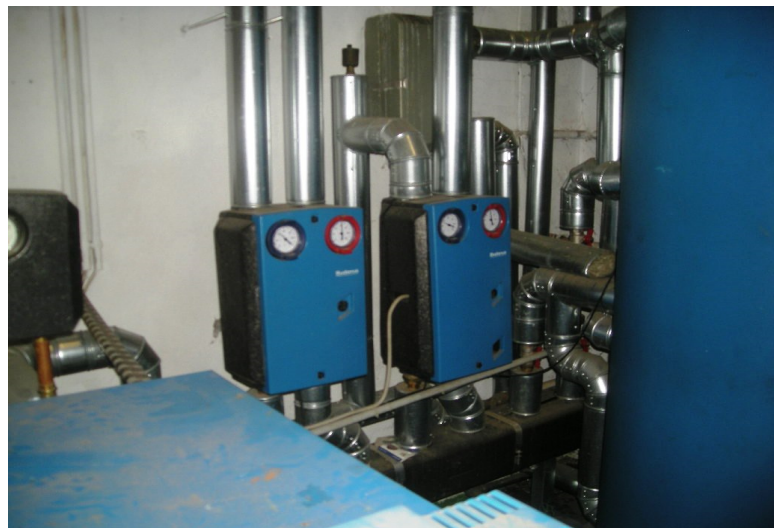
Heizkreisverteiler der Sportanlage
