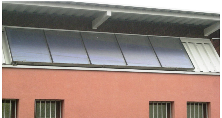
Thermische Solaranlage der Sportanlage
