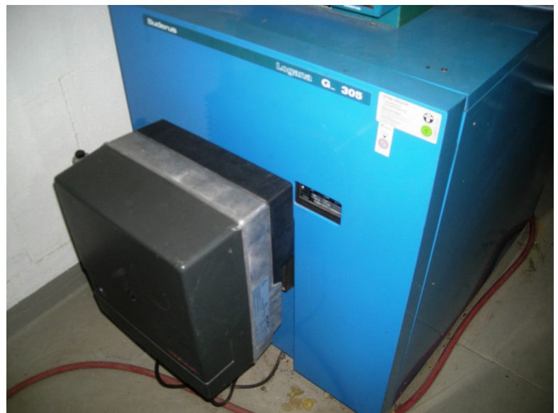
Heizungsanlage der Sportanlage
