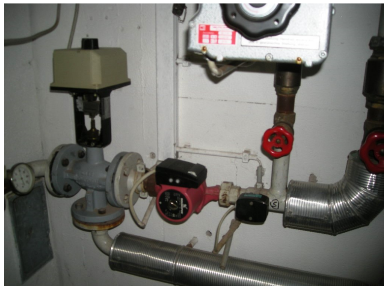
Heizkreispumpe der Sportanlage
