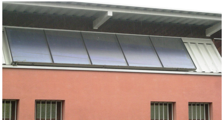
Thermische Solaranlage der Sportanlage
