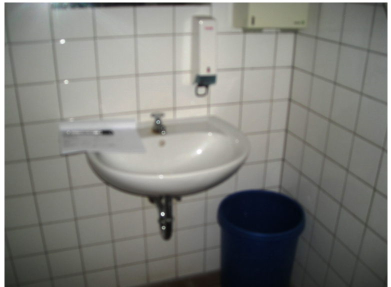
Waschtisch der Sportanlage
