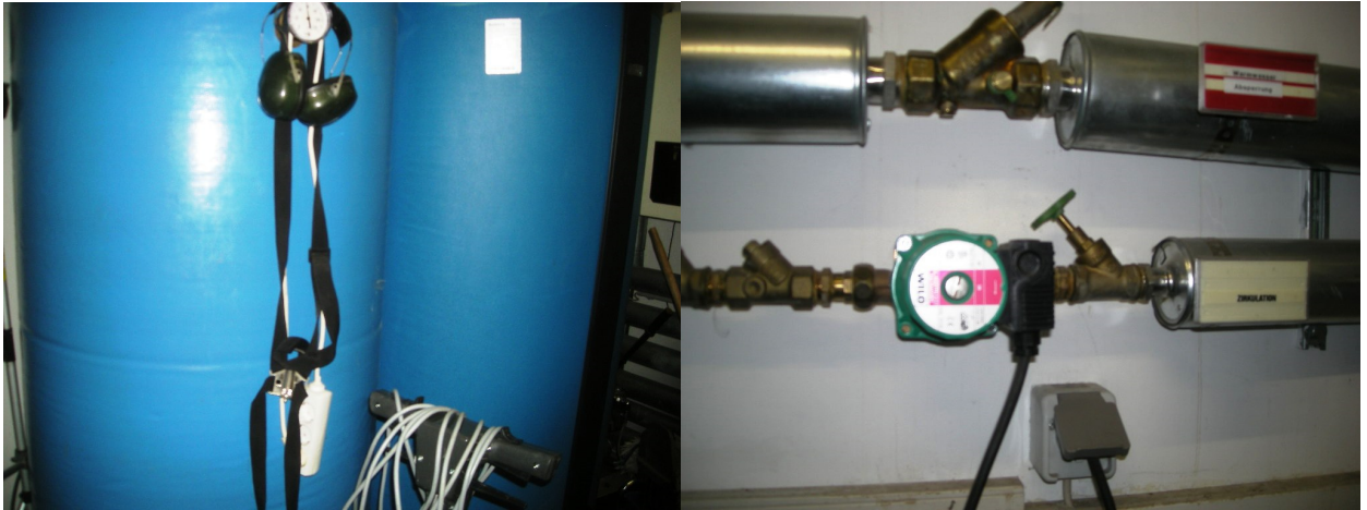
Puffer,- und Warmwasserspeicher mit Zirkulationspumpe der Sportanlage
