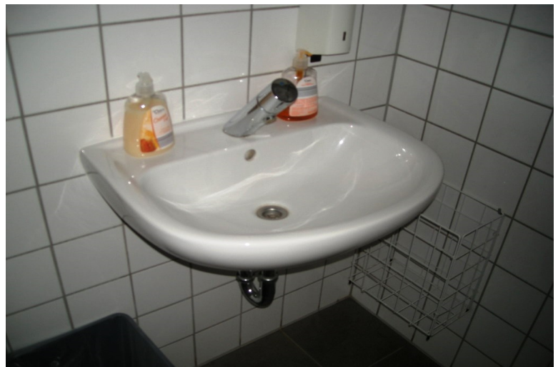
Waschtisch der Sportanlage
