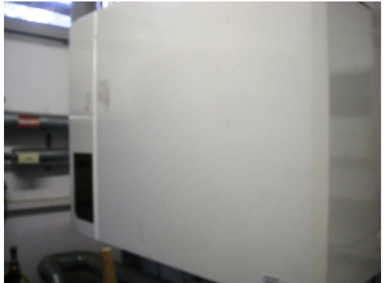
Heizungsanlage der Sportanlage
