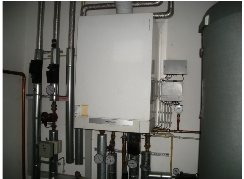
Heizungsanlage der Sportanlage
