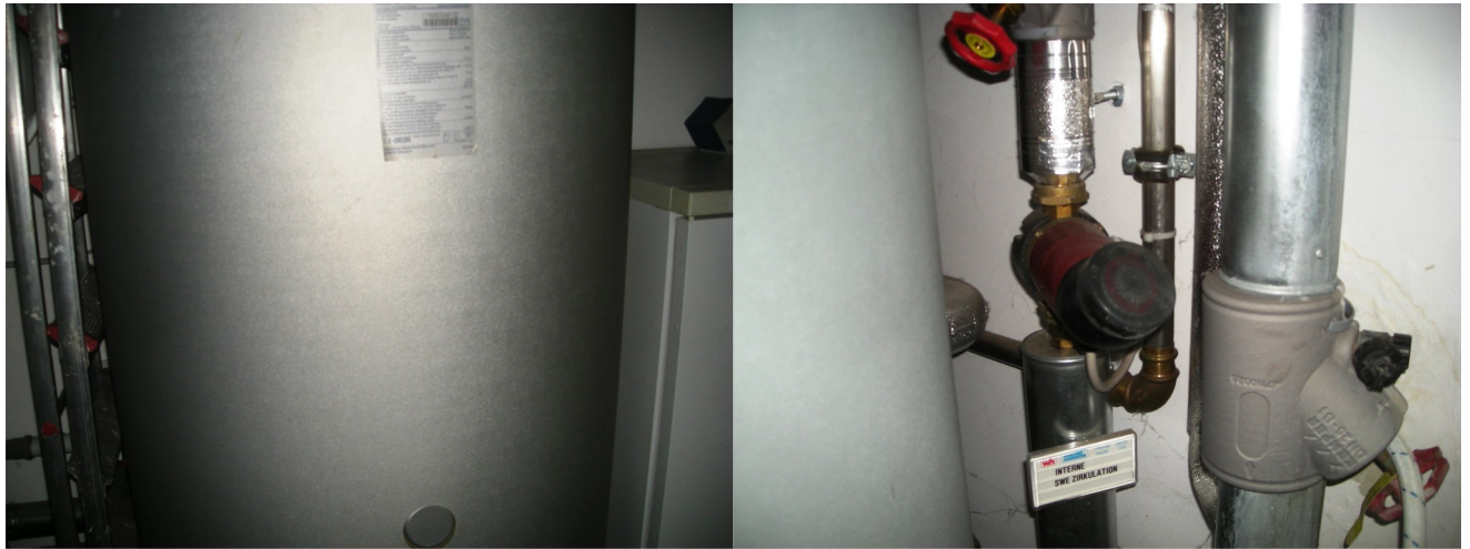
Warmwasserspeicher mit Zirkulationspumpe der Sportanlage
