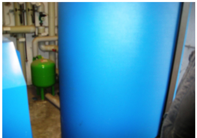
Warmwasserspeicher der Sportanlage
