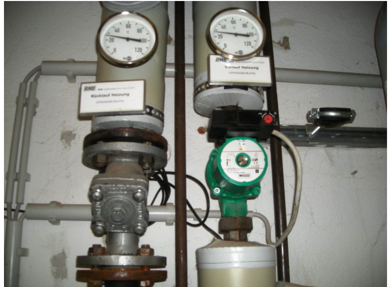
Heizkreispumpe der Sportanlage
