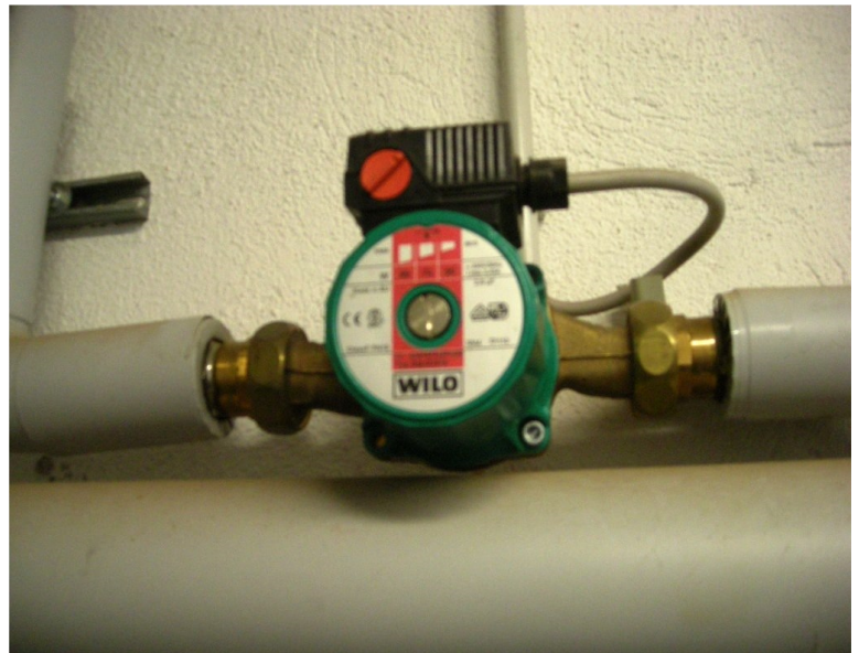
Zirkulationspumpe der Warmwasserbereitstellung
