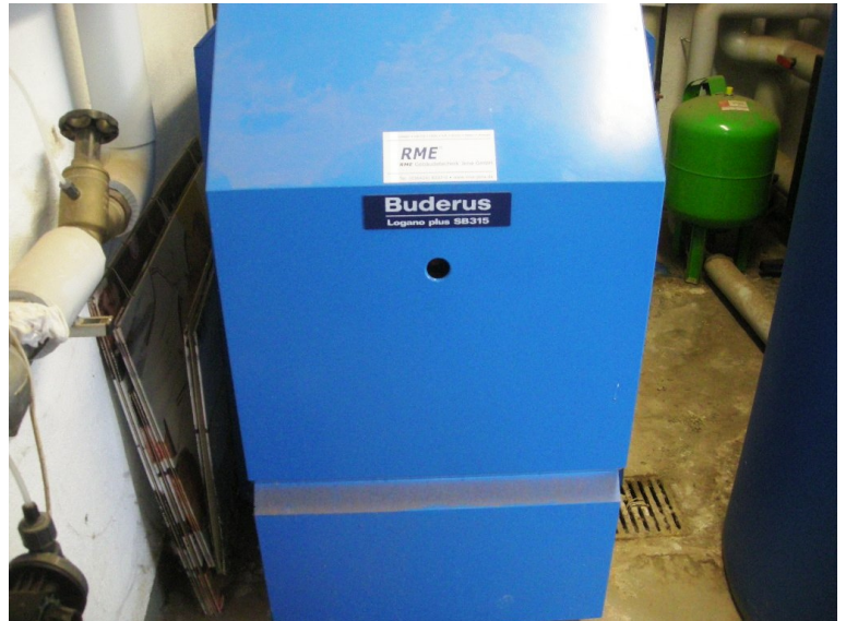
Heizungsanlage der Sportanlage
