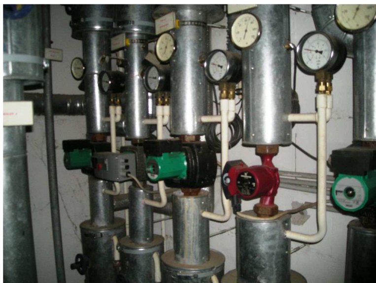
Heizkreisverteiler der Sportanlage
