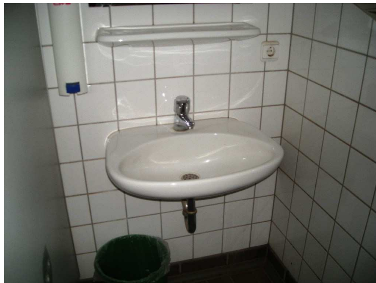
Waschtisch der Sportanlage
