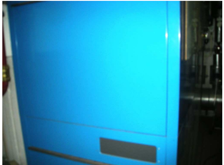
Warmwasserspeicher der Sportanlage
