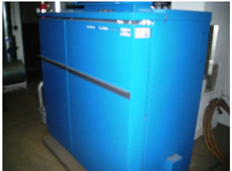
Heizungsanlage der Sportanlage
