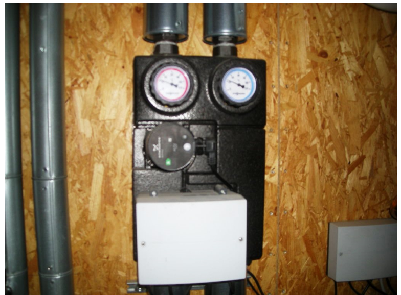
Heizkreispumpe der Lüftungsheizungsanlage
