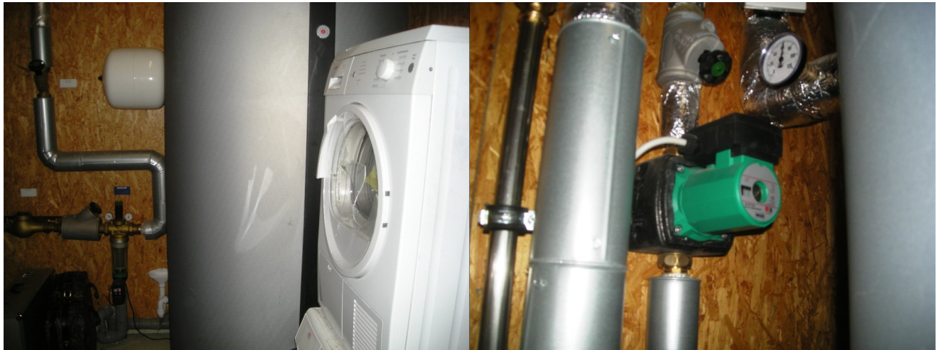
Warmwasserspeicher mit Zirkulationspumpe der Sportanlage
