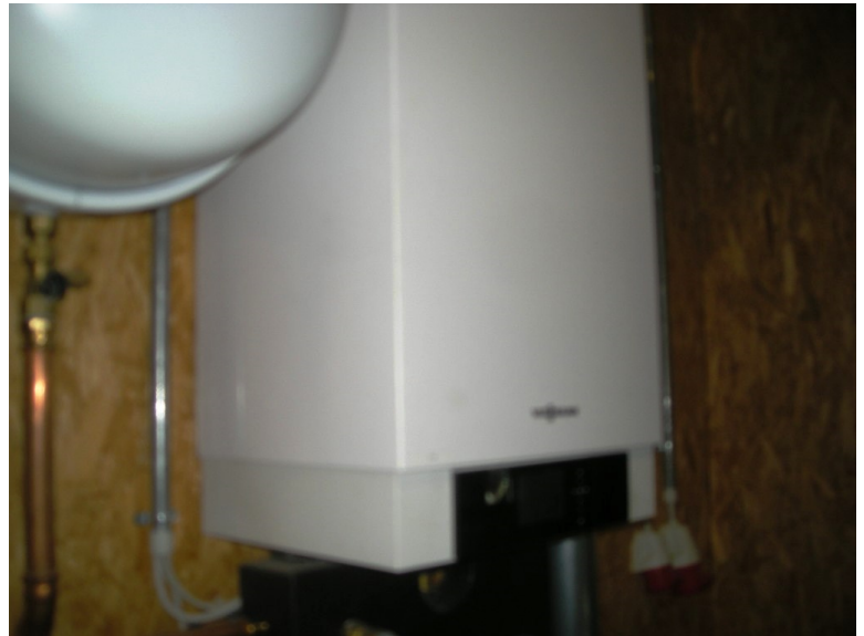
Heizungsanlage der Sportanlage
