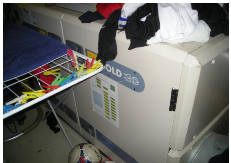
Lüftungsheizungsanlage der Sportanlage
