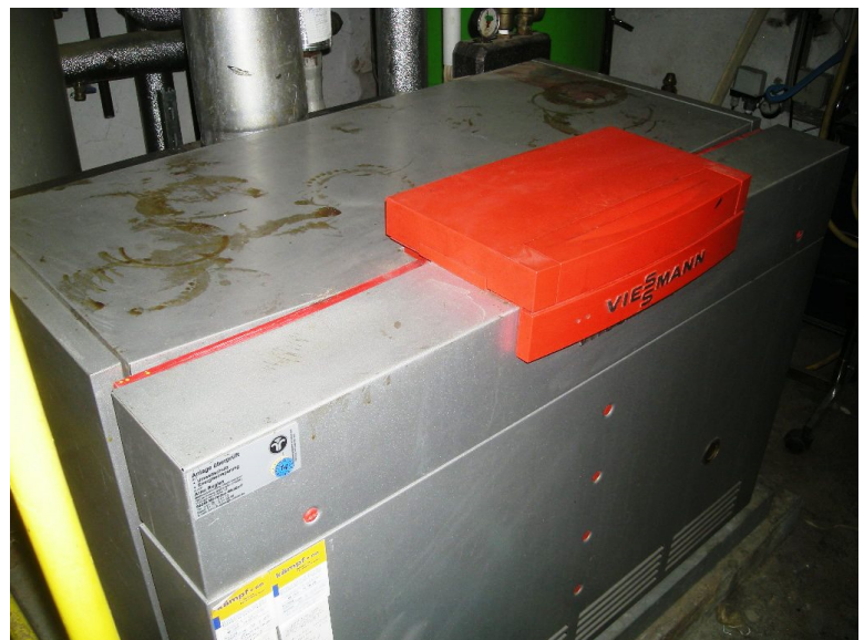
Heizungsanlage der Sportanlage
