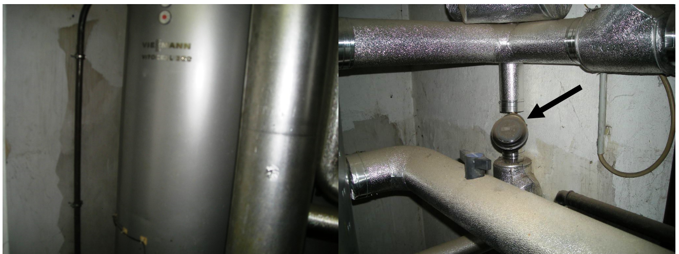
Warmwasserspeicher mit Zirkulationspumpe der Sportanlage
