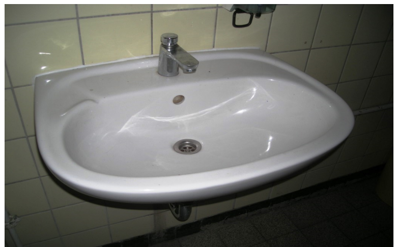
Waschtisch der Sportanlage
