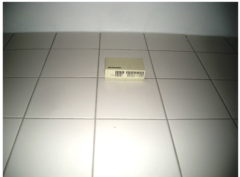
Hygrostat der Duschaumentlüftung
