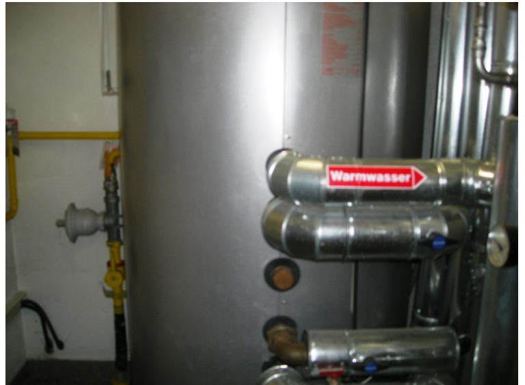
Warmwasserspeicher der Sportanlage
