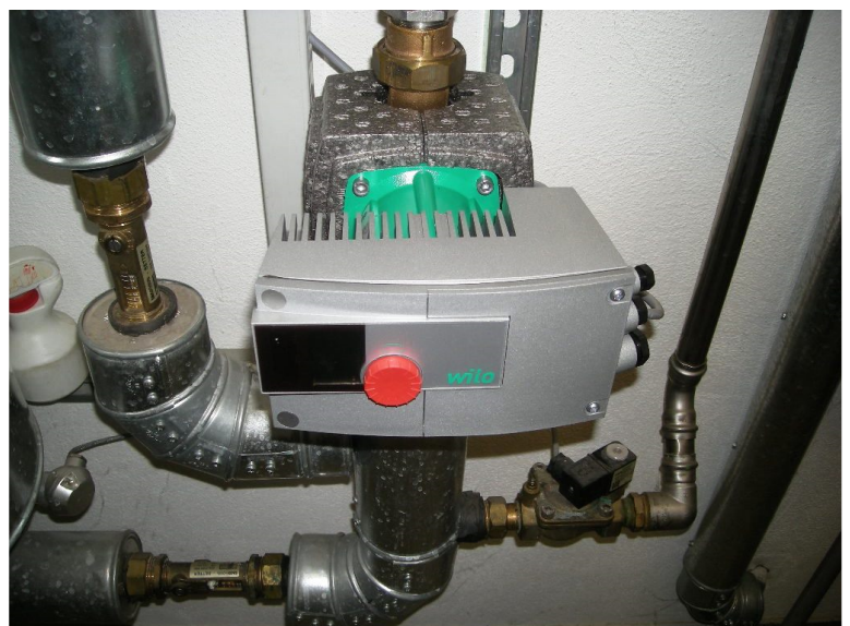
Zirkulationspumpe der Warmwasserbereitstellung
