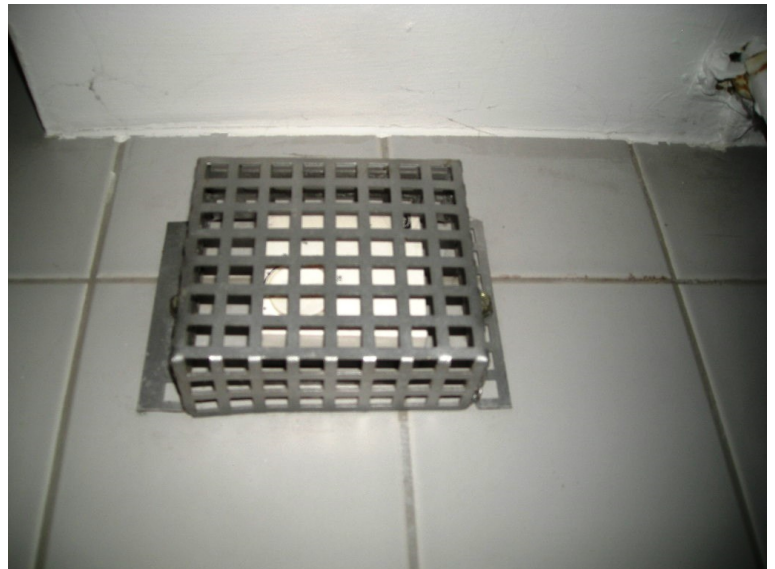
Hygrostat der Entlüftung der Duschräume
