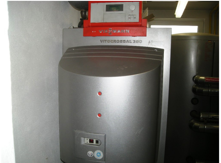
Heizungsanlage der Sportanlage
