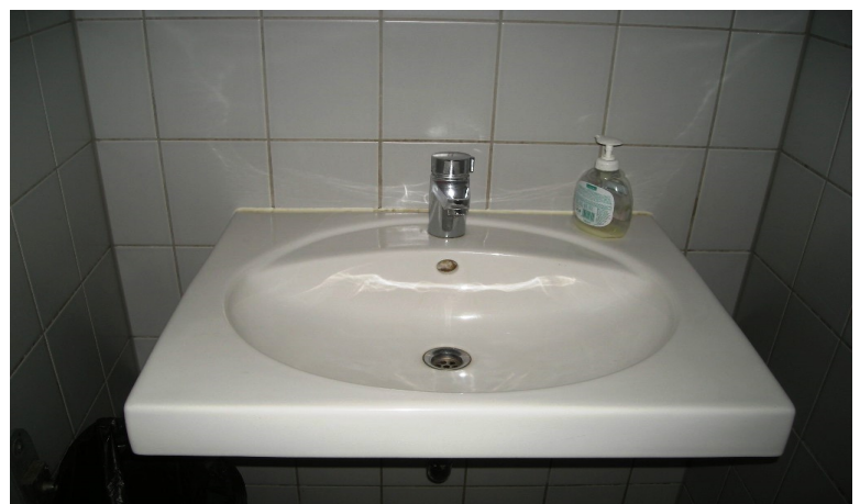
Waschtisch der Sportanlage
