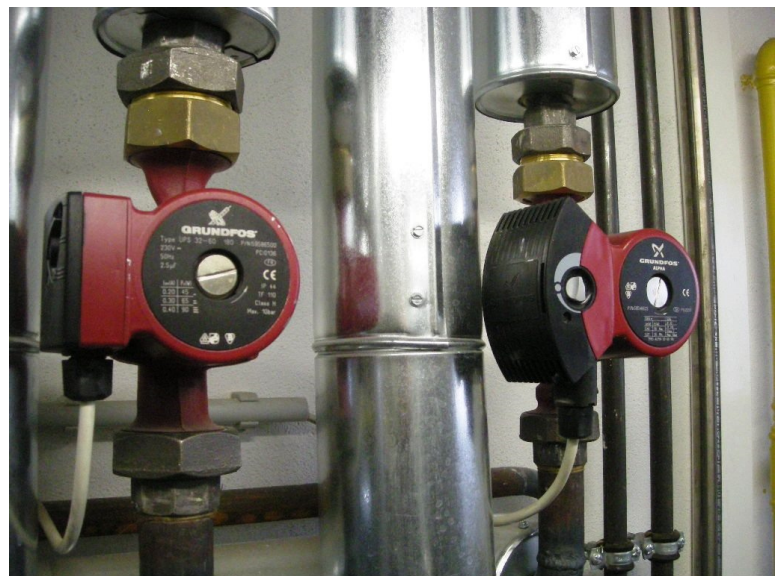
Heizkreisverteiler der Sportanlage
