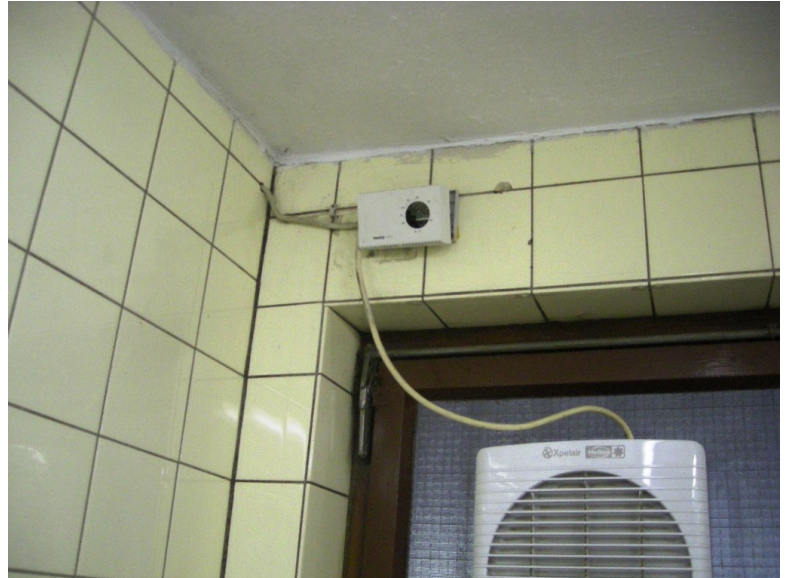
Hygrostat und Lüfter im Altbau
