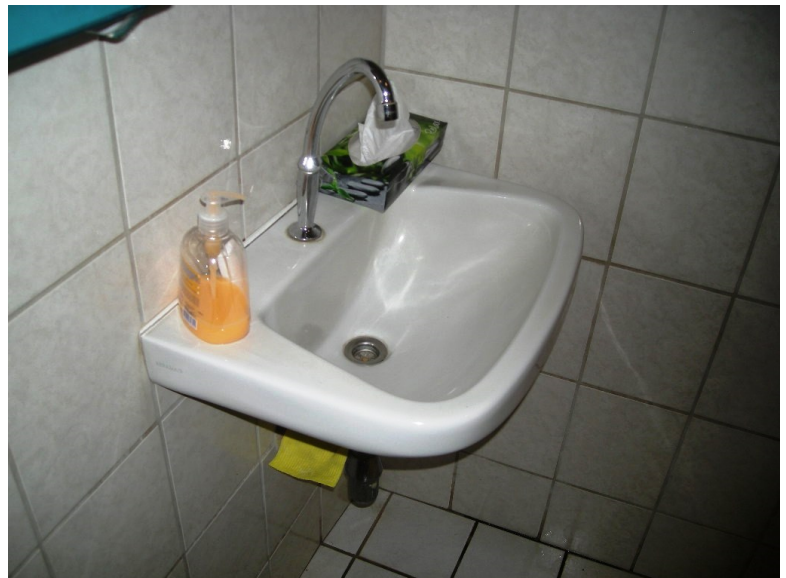
Waschtisch der Sportanlage
