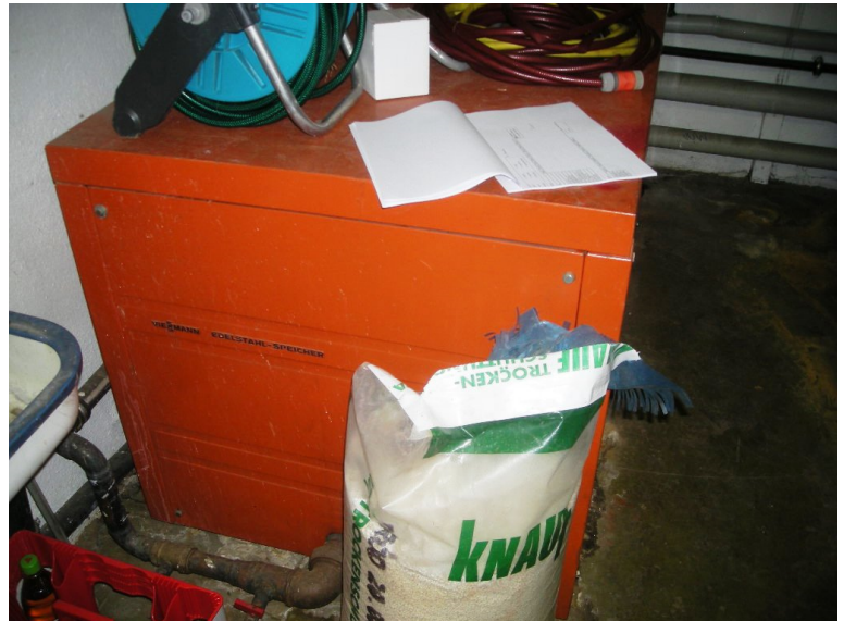
Warmwasserspeicher der Sportanlage
