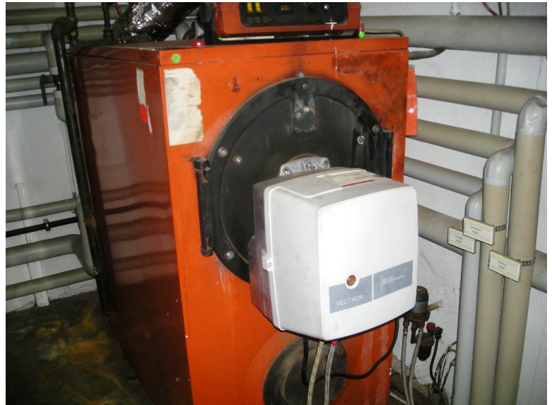
Heizungsanlage der Sportanlage
