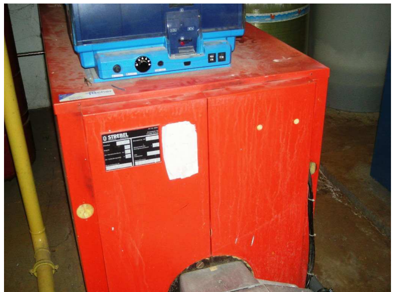
Heizungsanlage der Sportanlage
