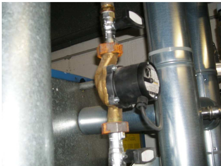
Zirkulationspumpe der Warmwasserbereitstellung
