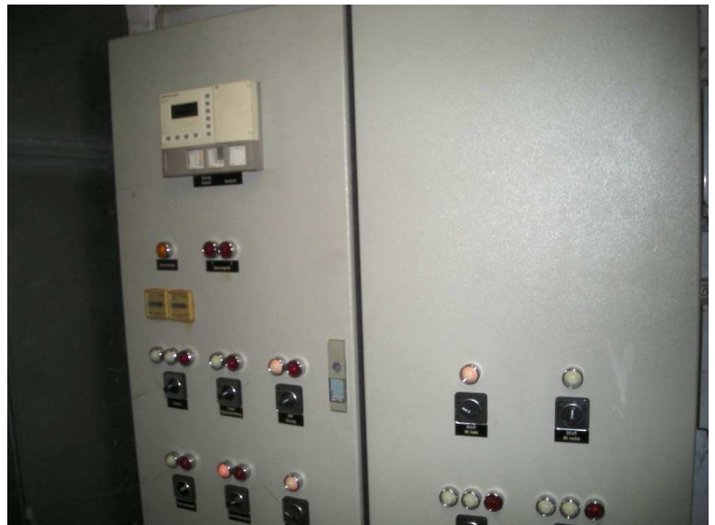
Schaltschrank der Heizungssteuerung
