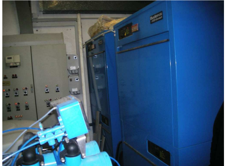
Warmwasserspeicher der Sportanlage
