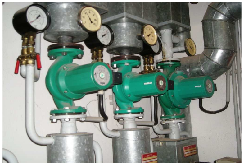
Heizkreisverteiler der Heizungsanlage
