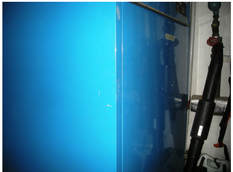
Warmwasserspeicher der Sportanlage
