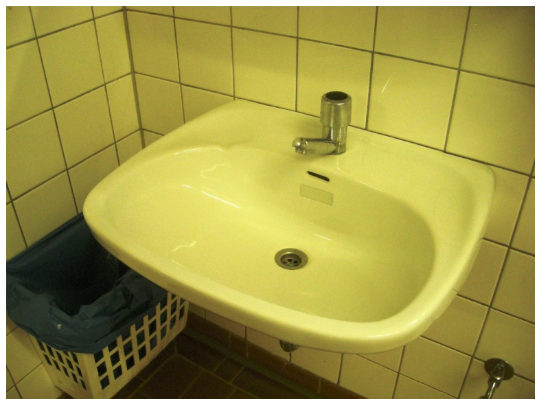
Waschtisch der Sportanlage
