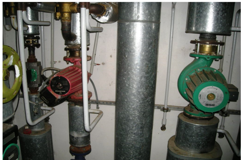
Heizkreisverteiler der Sportanlage
