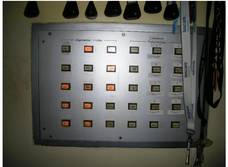
Zentrale Schaltung der Gebäudebeleuchtung
