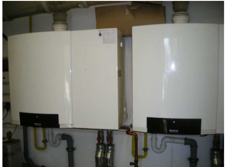
Heizungsanlagen der Sportanlage
