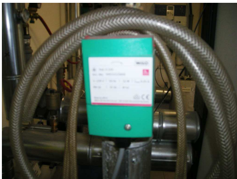
Zirkulationspumpe der Warmwasserbereitstellung
