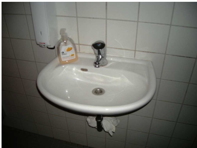
Waschtisch der Sportanlage
