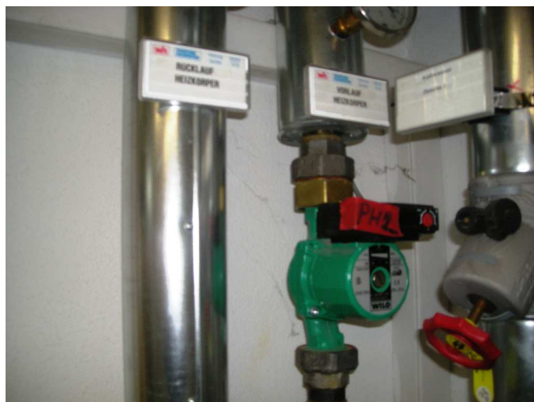
Heizkreispumpe der Sportanlage
