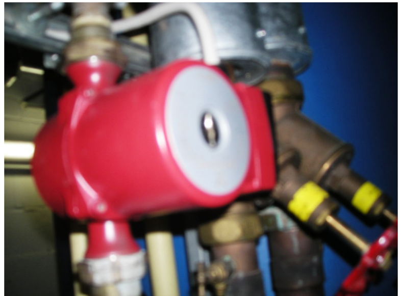
Zirkulationspumpe der Warmwasserbereitstellung
