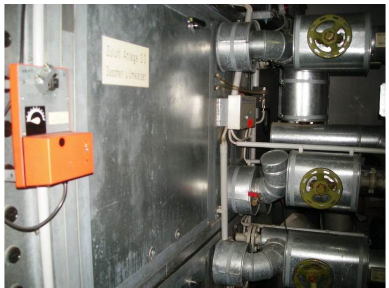
Lüftungsheizungsanlage der Sportanlage
