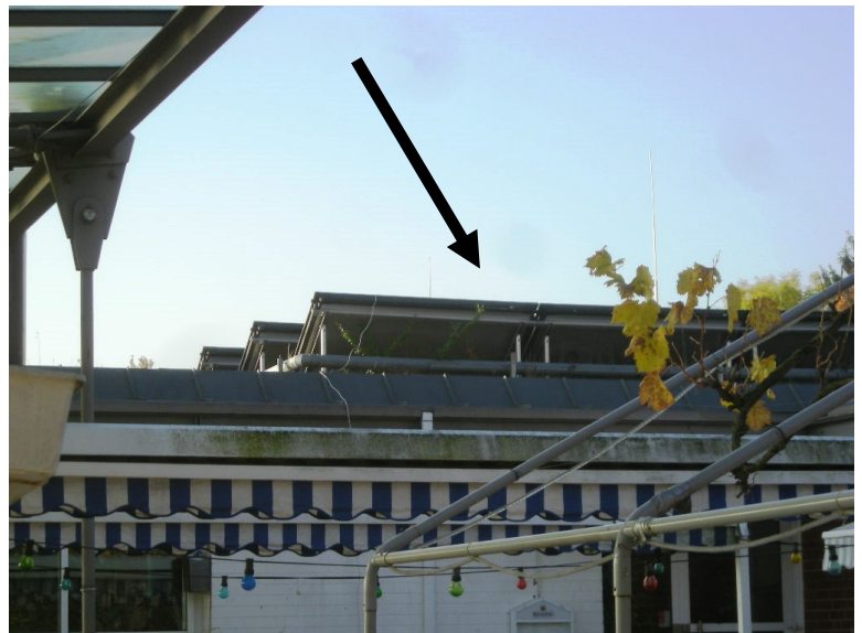
Thermische Solaranlage der Sportanlage
