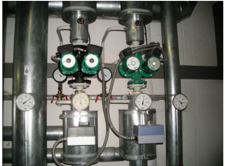
Heizkreisverteiler der Sportanlage
