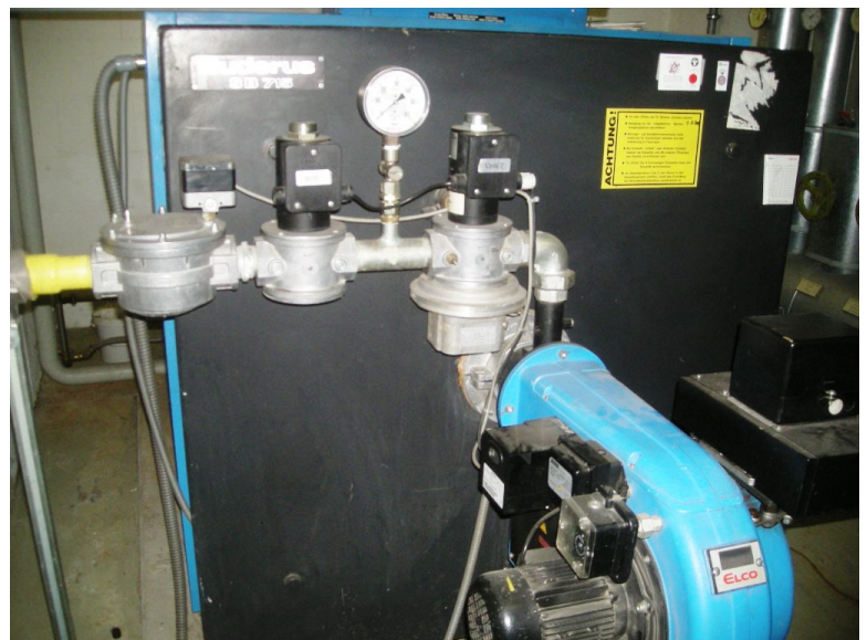
Heizungsanlage der Sportanlage
