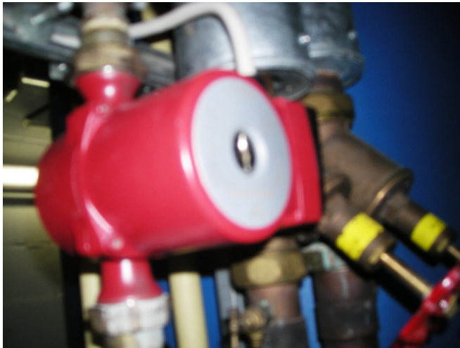
Zirkulationspumpe mit Warmwasserspeicher der Sportanlage
