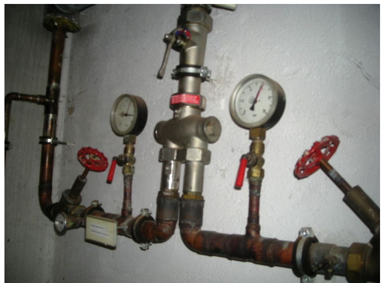
Mischwasserthermostat der Warmwasserbereitstellung
