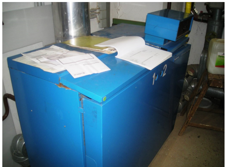
Heizungsanlage der Sportanlage
