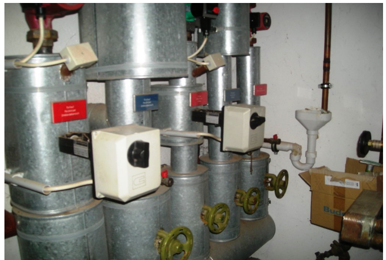
Heizkreisverteiler der Sportanlage
