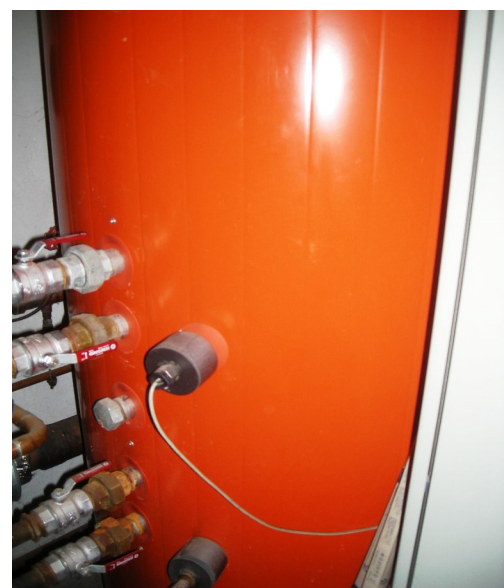
Warmwasserspeicher der Sportanlage
