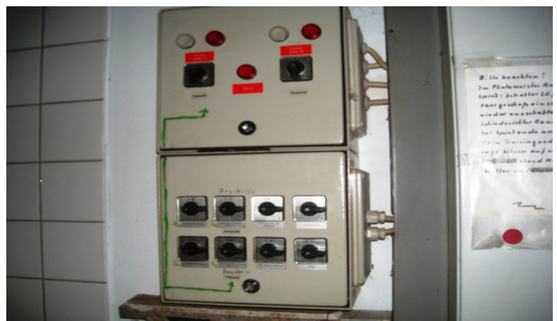
Zentrale Schaltung der Beleuchtung
