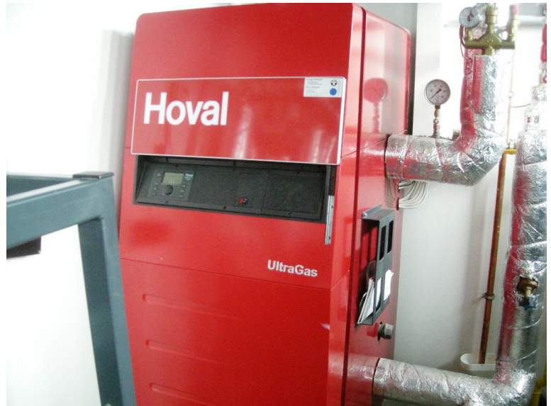
Heizungsanlage der Sportanlage
