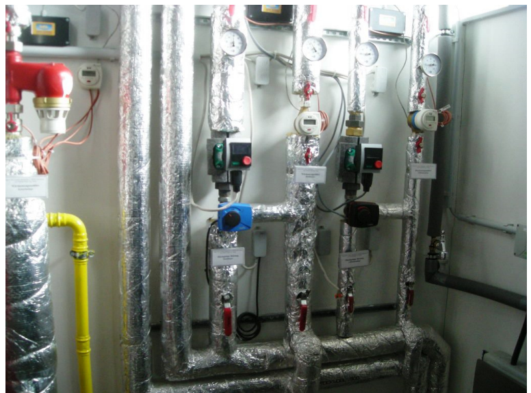
Heizkreisverteiler der Sportanlage
