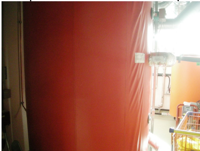
Warmwasserspeicher mit der Zirkulationspumpe der Sportanlage
