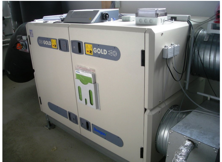
Lüftungsheizungsanlage der Sportanlage
