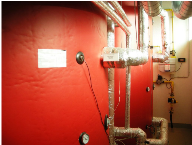
Pufferspeicher mit Frischwasserstation der Sportanlage
