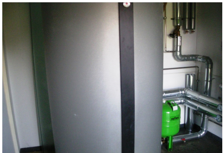
Warmwasserspeicher der Sportanlage
