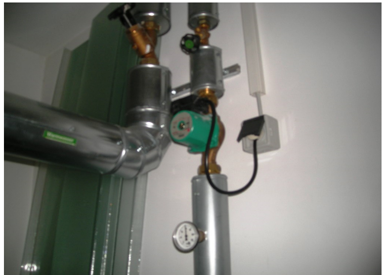
Zirkulationspumpe der Warmwasserbereitstellung
