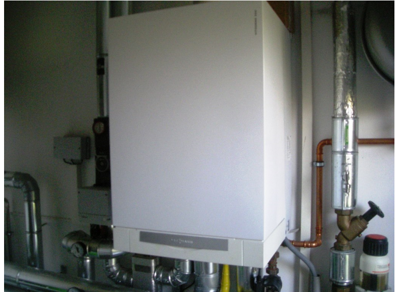
Heizungsanlage der Sportanlage
