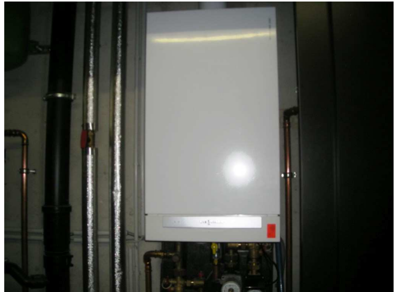
Heizungsanlage der Sportanlage
