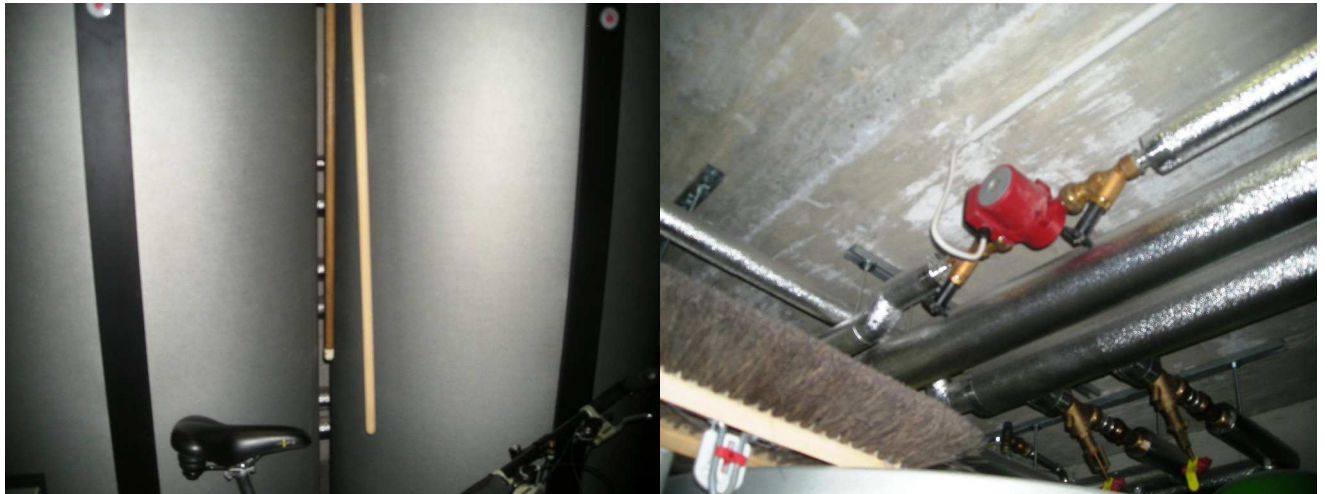
Warmwasserspeicher und Zirkulationspumpe der Warmwasserbereitstellung
