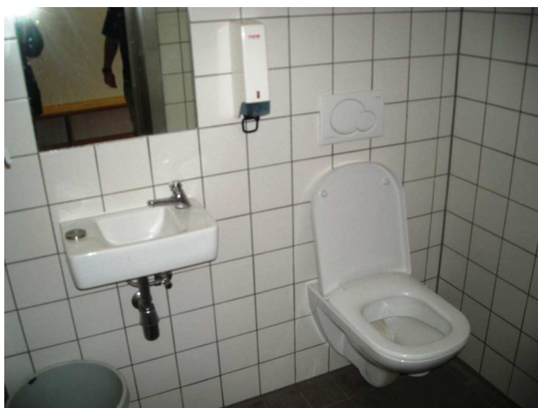
Waschtisch der Sportanlage
