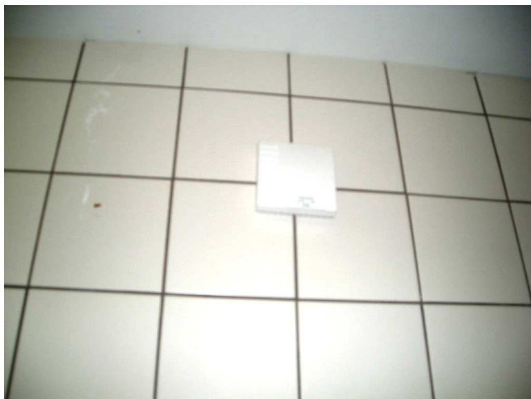
Hygrostat der feuchtigkeitsgesteuerten Be- und Entlüftung der Duschräume
