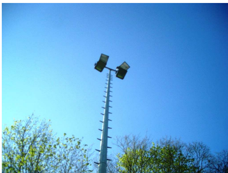
Flutlichtanlage des Kunststoffrasenplatzes
