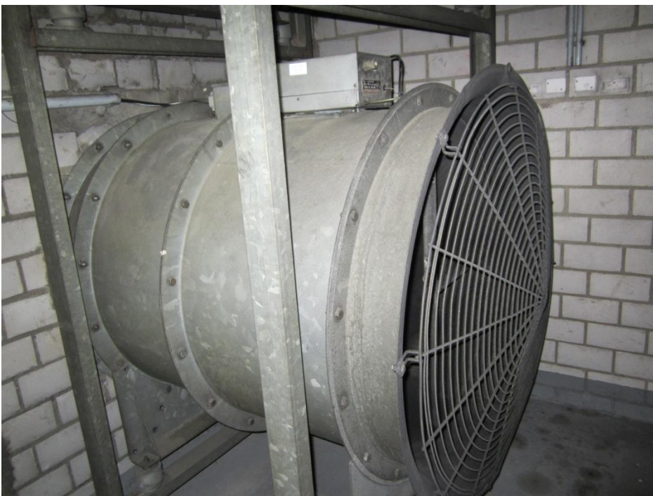
Abbildung 7-2: Lüftungsanlage „13.R Zentrale Außenluftversorgung (West) U2“
