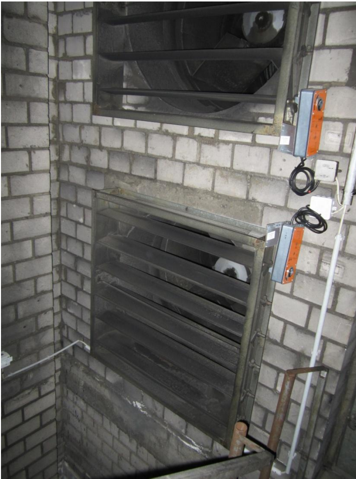
Abbildung 7-1: Lüftungsanlagen „13.R Zentrale Außenluftversorgung (West) U2“
