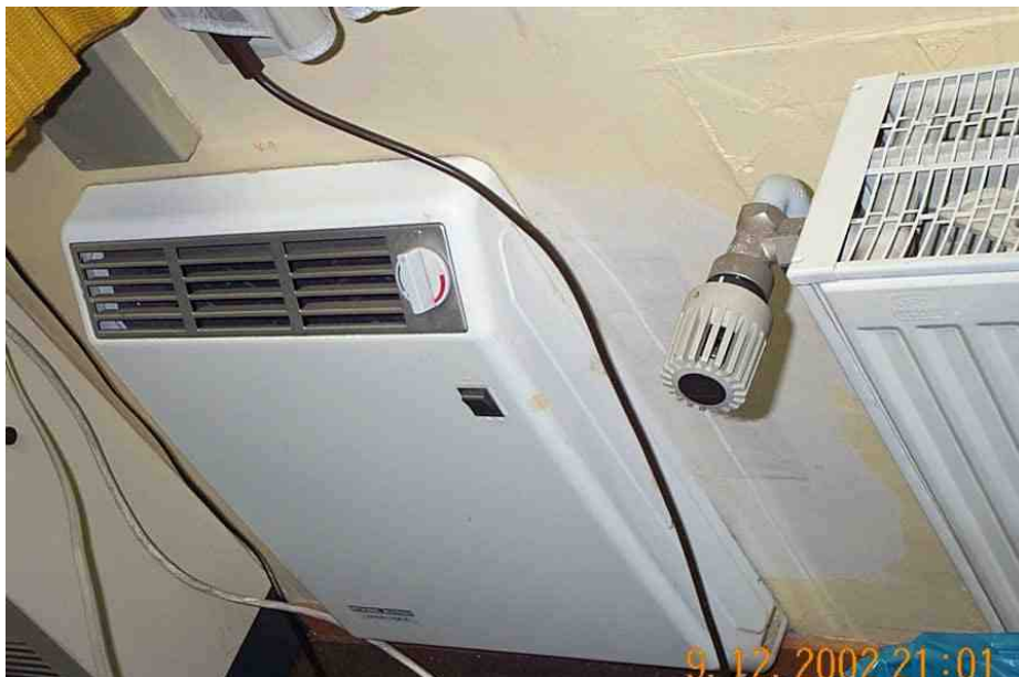
Bild 22 Folgen veralteter Bausubstanz
