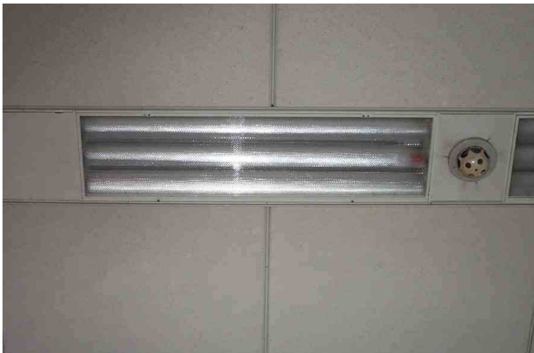
Bild 21 Standardleuchte 3-reihig Turnhalle
