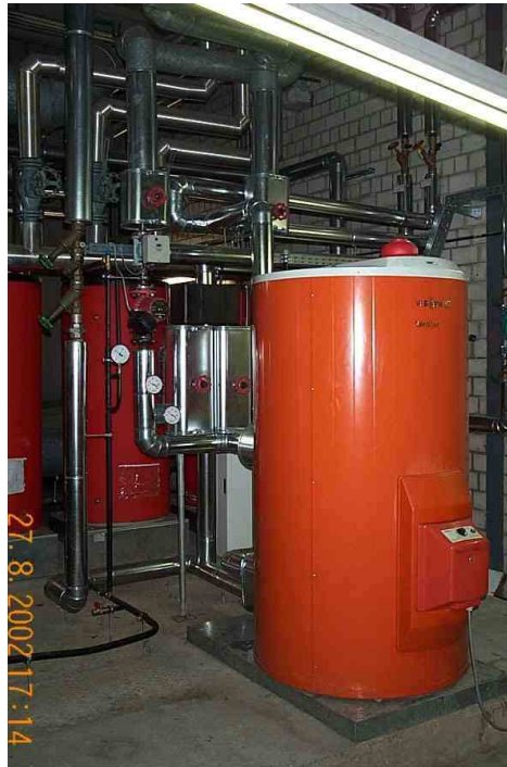
Bild 13 und Bild 14 Warmwasserspeicher 1 (Bauteil B) und 2 (Bauteil A)
