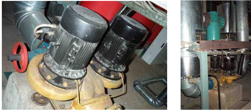
Bild 10 und Bild 11 Pumpengruppe HV und dito mit Filter
