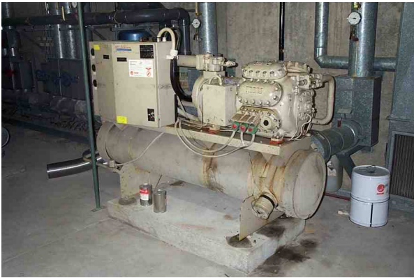
Bild 15 und Bild 16 Kältemaschine
