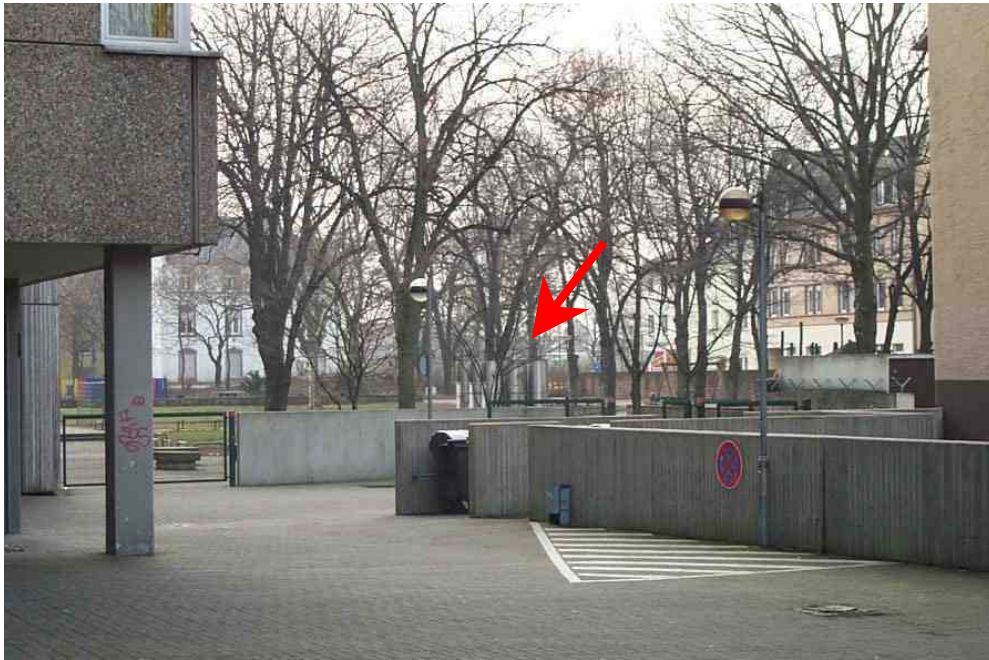
Bild 3 auskragende Decken, ungedämmte Stahlbetonstütze und öffentlich zugängliche Ansaugung für die Zuluft für Bauteil A/B im Park
