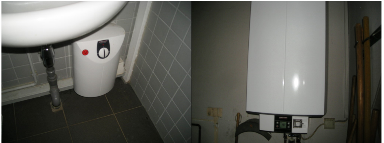
Dezentrale Warmwasserspeicher der Betriebshöfe
