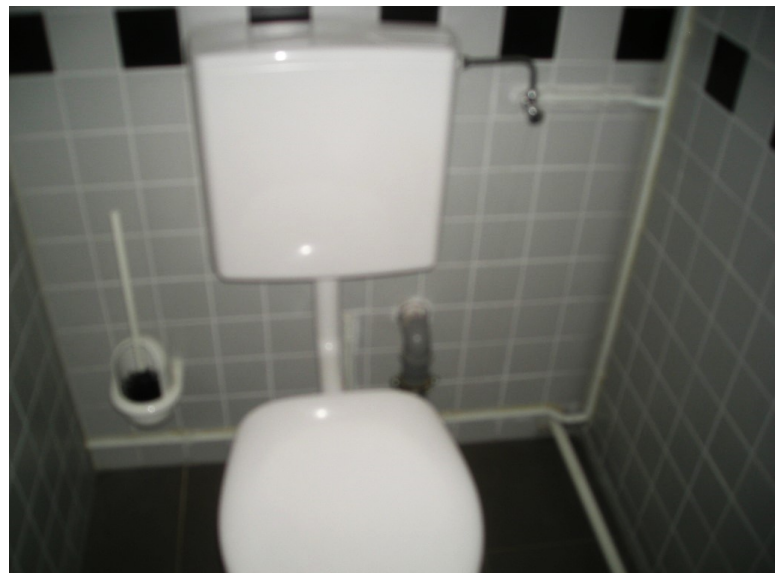
Toilette des Betriebshofes
