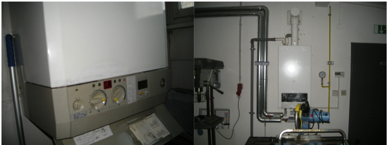
Heizungsanlagen der verschiedenen Bereiche des Betriebshofes
