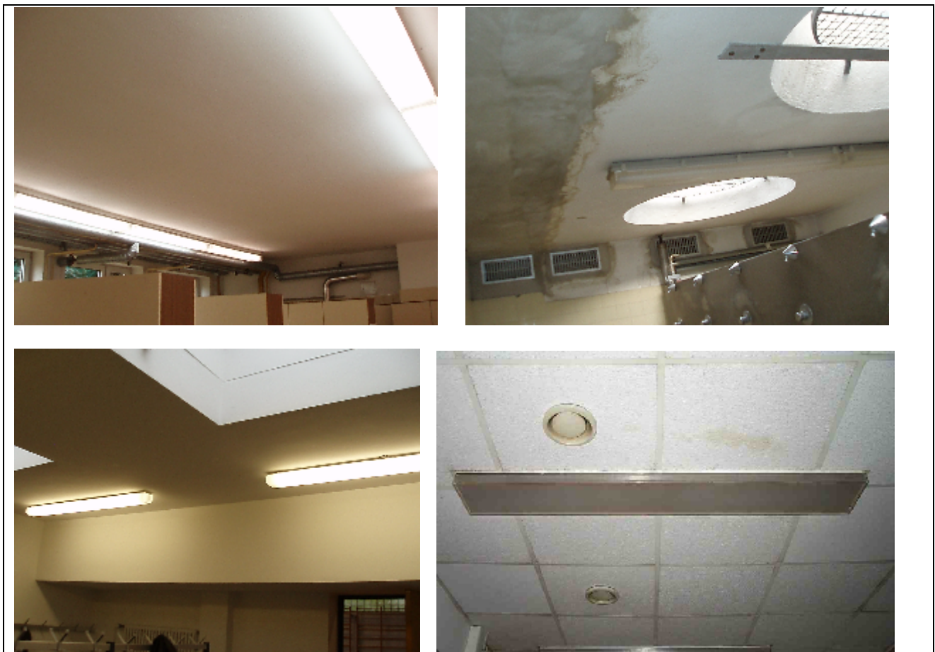
Bild 7 Typische Beleuchtungsanlagen Umkleiden
