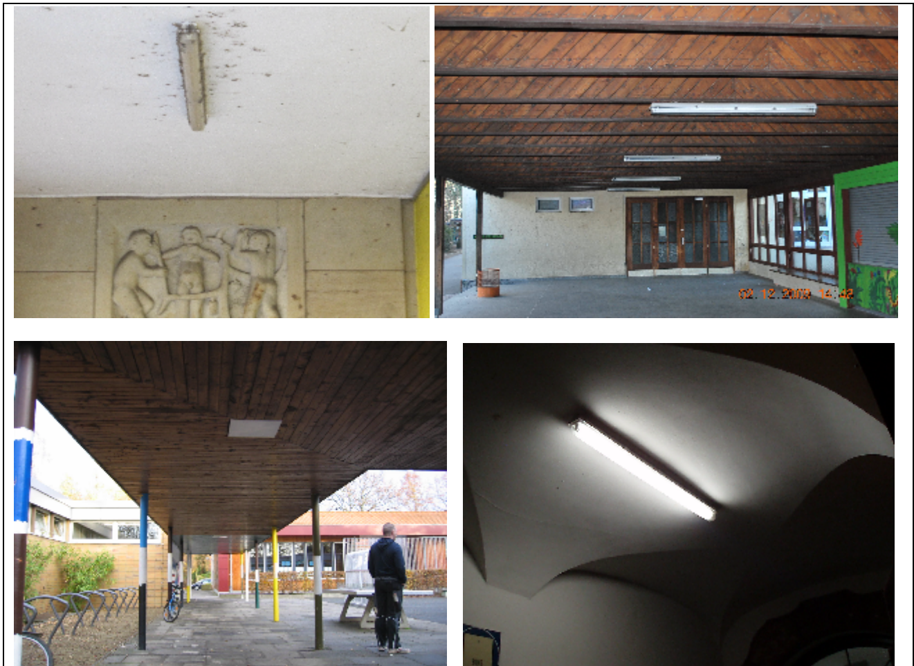
Bild 9 Unterbauleuchten im Außenbereich
