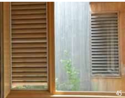
45 Nachtluftklappe im Schulgebäude
