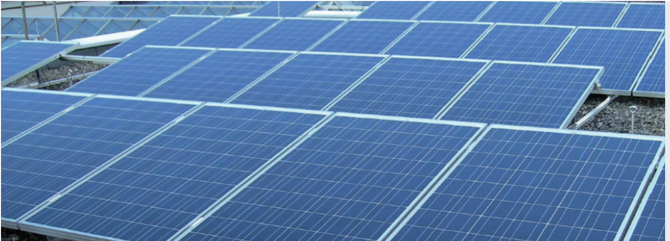
Photovoltaikanlage/Foto: © Hochbauamt Frankfurt
