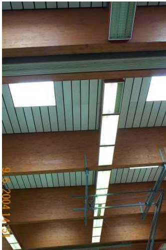
Bild 2 Deckenansicht Leuchten Sporthalle
